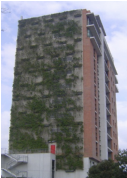
Figura 9. Godínez R. Fachada manchada a consecuencia de poca uniformidad en el crecimiento de la planta cubridora, debido al diseño y ubicación de jardineras y complicación en el riego y mantenimiento transmite poco éxito de la propuesta. Mayo 2014. Edificio de Oficinas "El Naranjo" Condado Naranjo zona 4 de Mixco, Guatemala.
