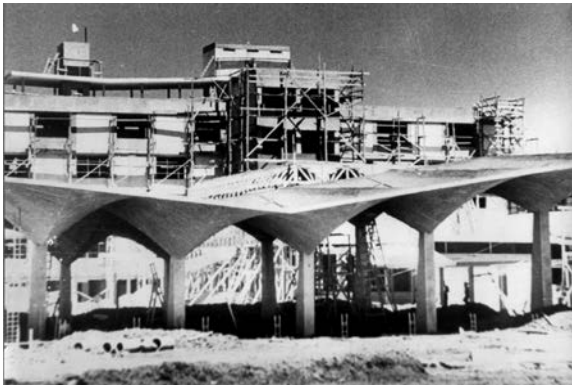
Figura 7: Auditorio Francisco Vela de la Facultad de Ingeniería de la Universidad de San Carlos de Guatemala en construcción, 1957. Foto: reproducción de archivo oficina de divulgación facultad de Ingeniería, USAC.
