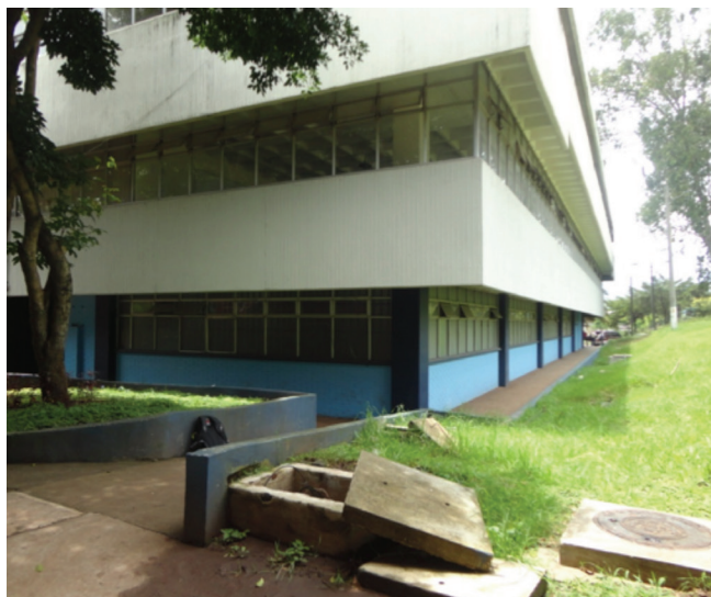
Fachada Nor-este se muestra las cajas de instalaciones destapadas, que constituye un peligro para los usuarios.
